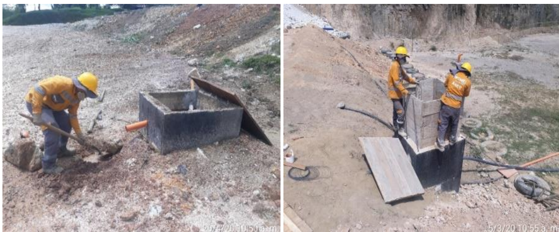
Imagen 6. Continuidad de cajas de recolección de lixiviado
