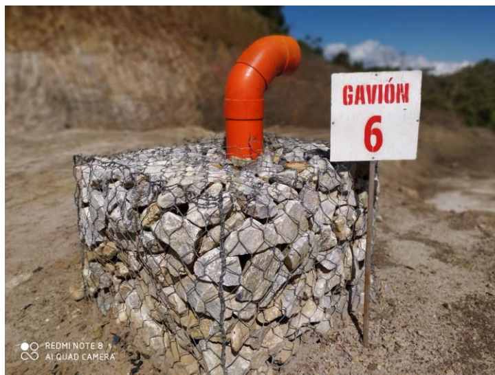
Ilustración 4. Chimenea de desfogue
