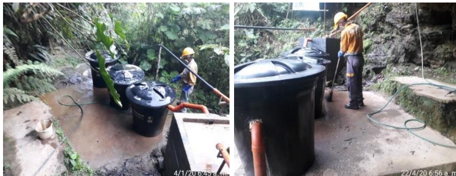
Imagen 5. Sistema de tratamiento de lixiviado
